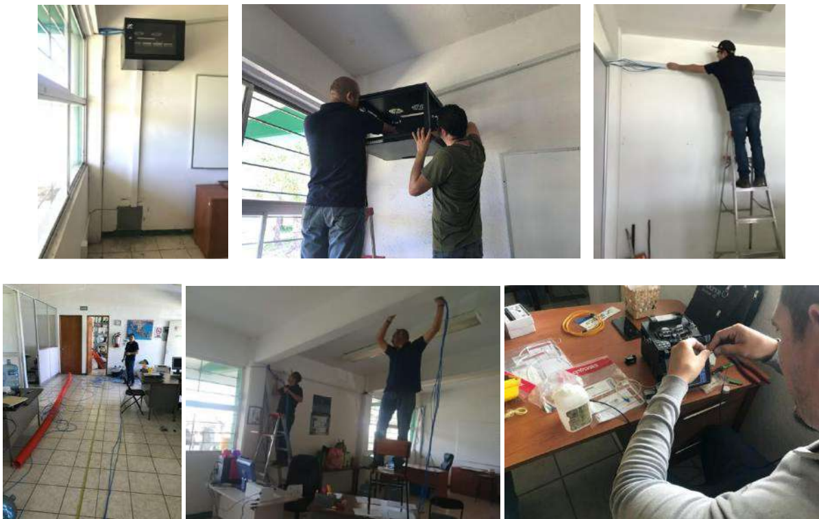
Figura 6. Instalación de cableado estructurado y fibra óptica en el departamento de Fomento Productivo
