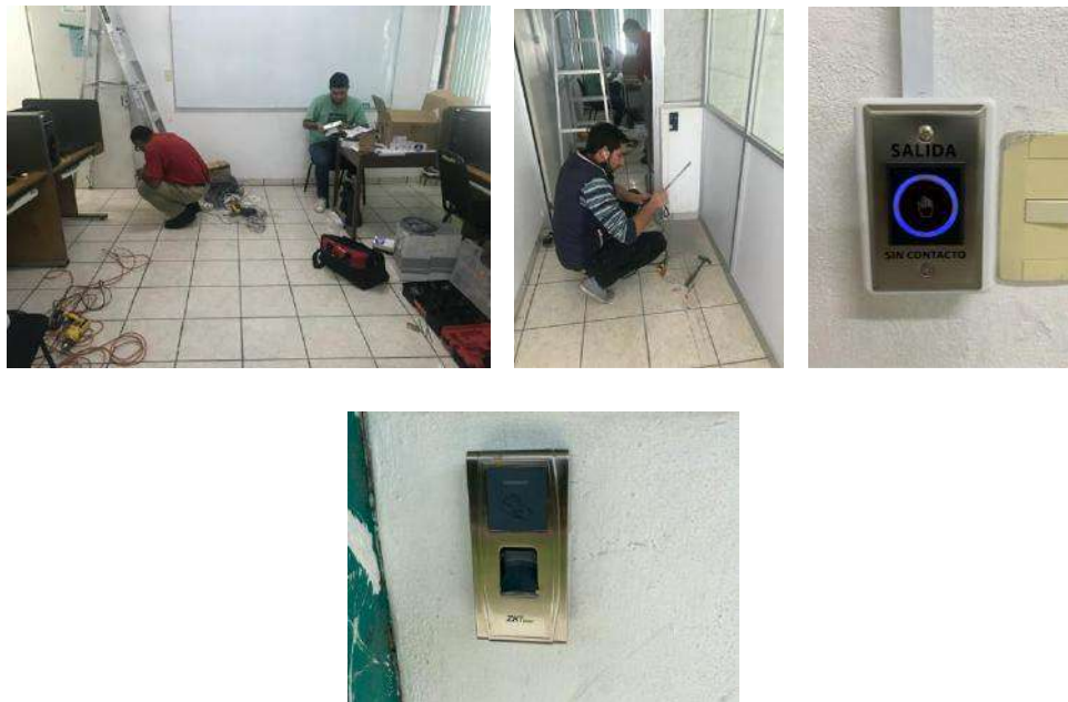
Figura 3. Automatización de accesos a laboratorios de cómputo.
