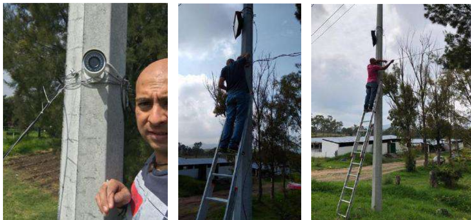
Figura 10. Instalación de cámaras de seguridad
