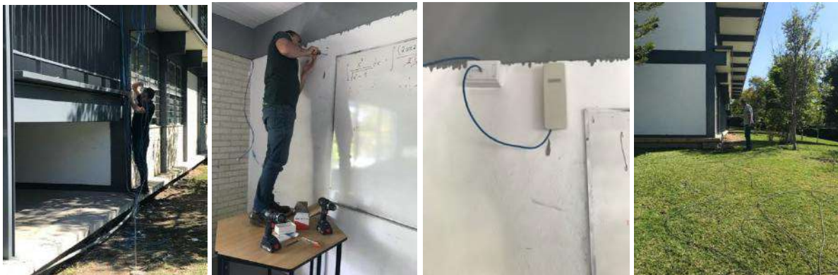
Figura 8. Cableado estructurado y nodos en el Edificio C
